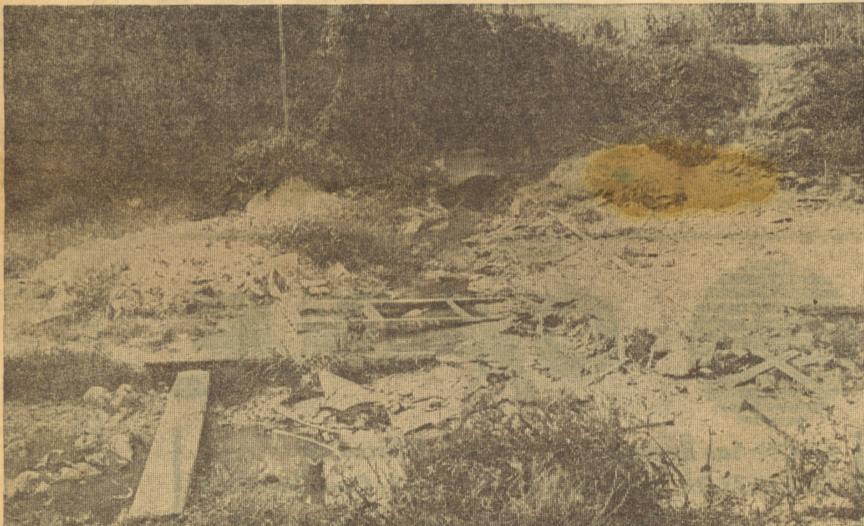
El colector que, obstruido, causa las inundaciones
